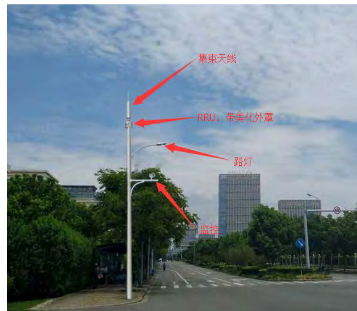
图 8-5 高杆，RRU 上塔 (带美化外罩)
