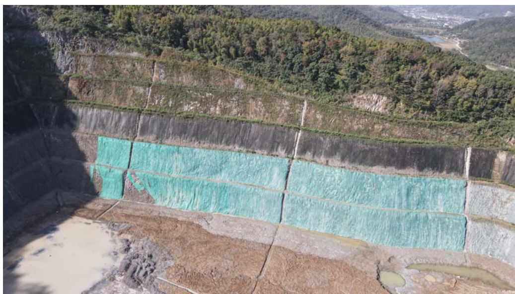
照片 3—2 B 段现状边坡
