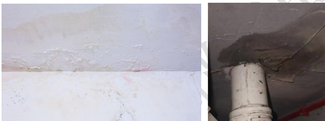
图 38 顶棚涂料起皮渗漏
