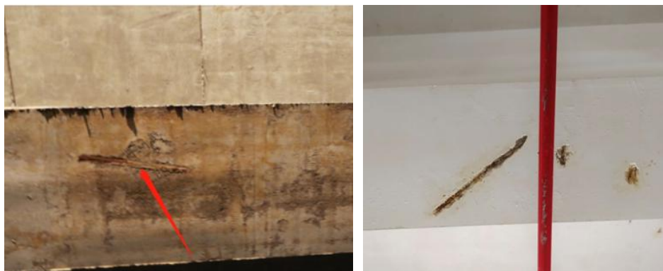
图 81 混凝土结构钢筋锈蚀膨胀
