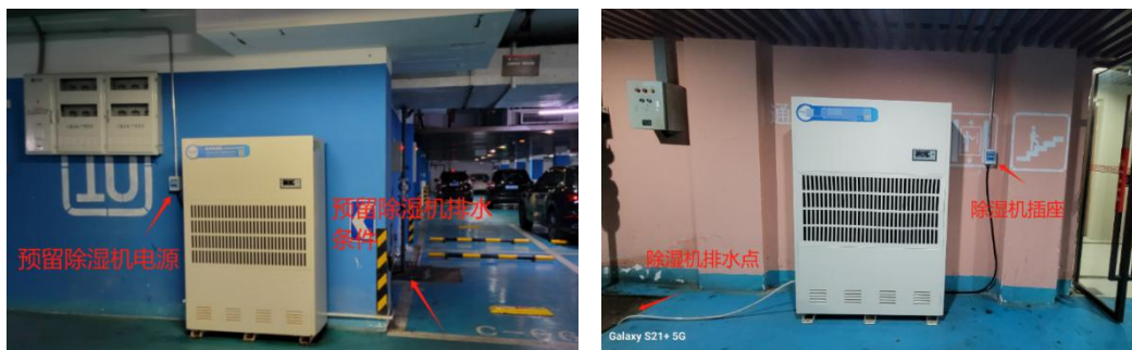
图 73 地下车库车道旁、入户门厅旁安装除湿机
