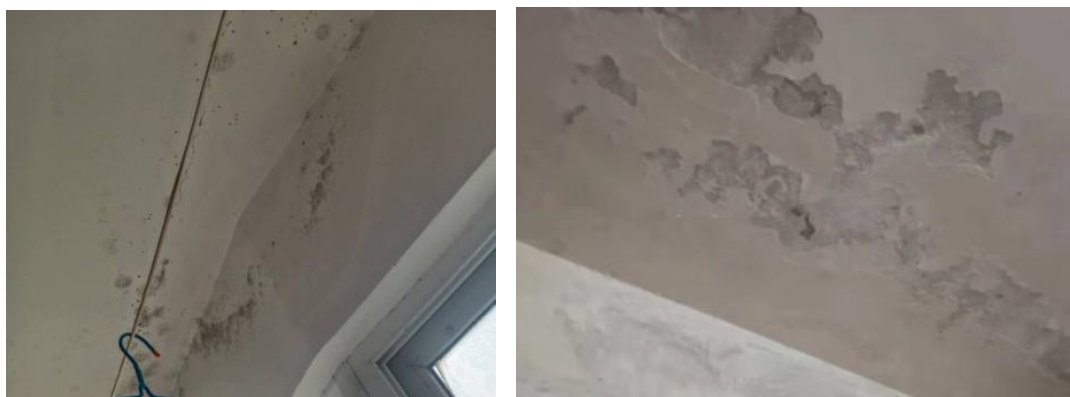
图 37 顶棚霉斑脱落
