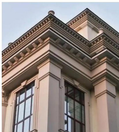
图 56 外立面装饰条开裂
