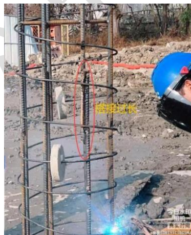
图9 搭接长度过长造成总体笼长不足
