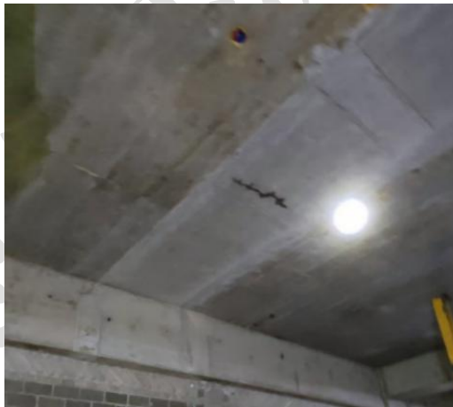
图 23 地下室顶板后浇带渗漏现场图
