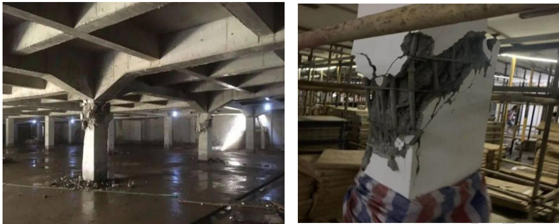
图2 地下室柱发生剪切破坏
