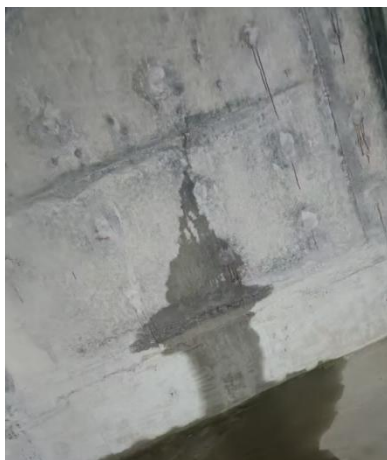
图 19 后浇带渗漏现场图
