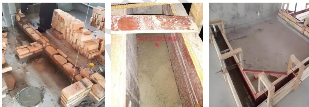
图 31 未设置混凝土反坎、反坎未凿毛、使用木撑条
