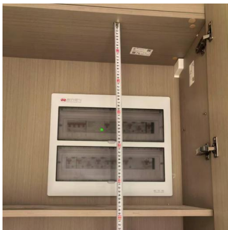
图 85 户内配电箱设置于柜子内
