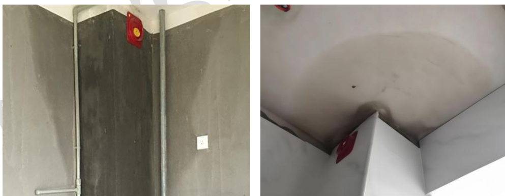
图 51 厨房烟道根部渗漏
