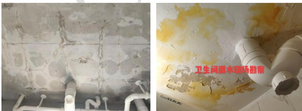
图 48 卫生间顶棚楼板渗漏
