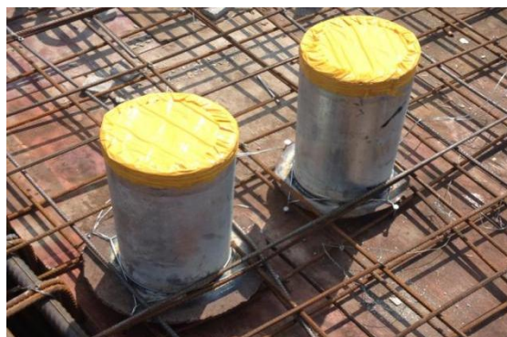
图 44 传统铁丝固定造成渗漏
