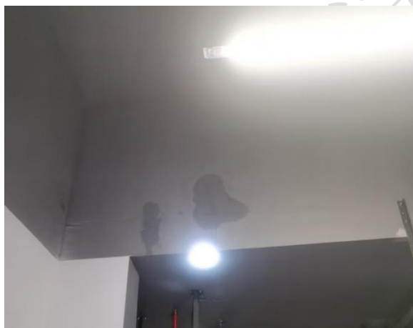
图 28 高低跨梁侧渗漏
