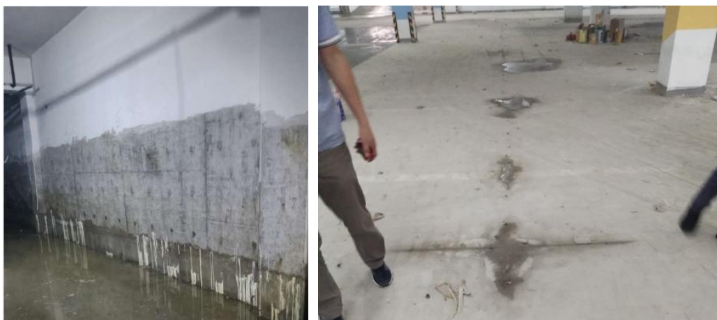
图 12 地下室侧墙、地板渗漏现场图
