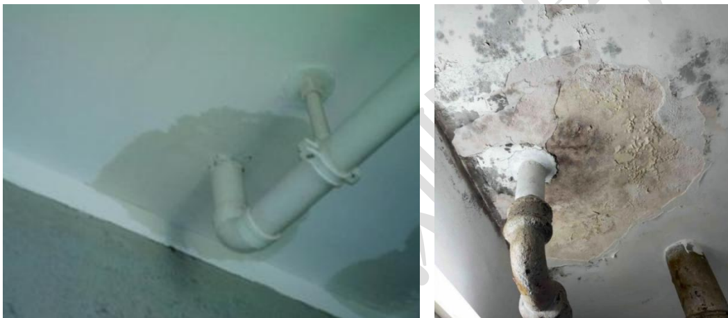
图 43 管根处渗漏水 and 顶棚涂料脱落
