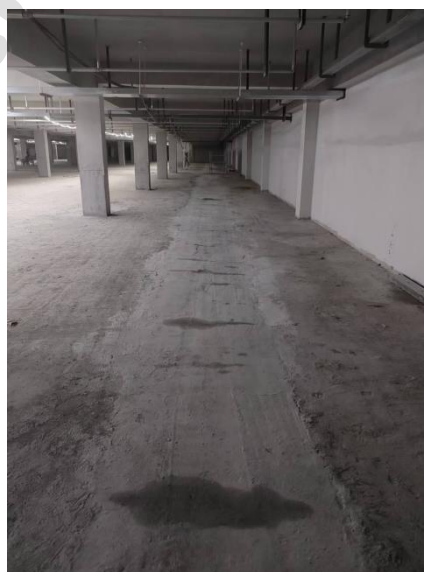
图 13 地下室底板渗漏现场图
