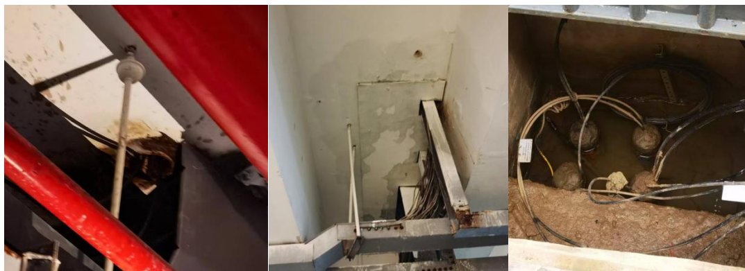
图 21 穿管位置渗漏现场图
