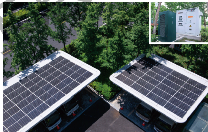
“光储直柔”一体化充电站
