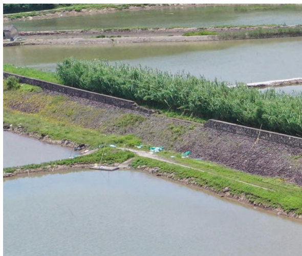
海堤部分防浪墙坍塌
