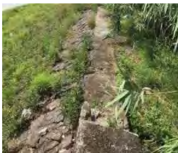
海堤堤顶路面和护面破损
