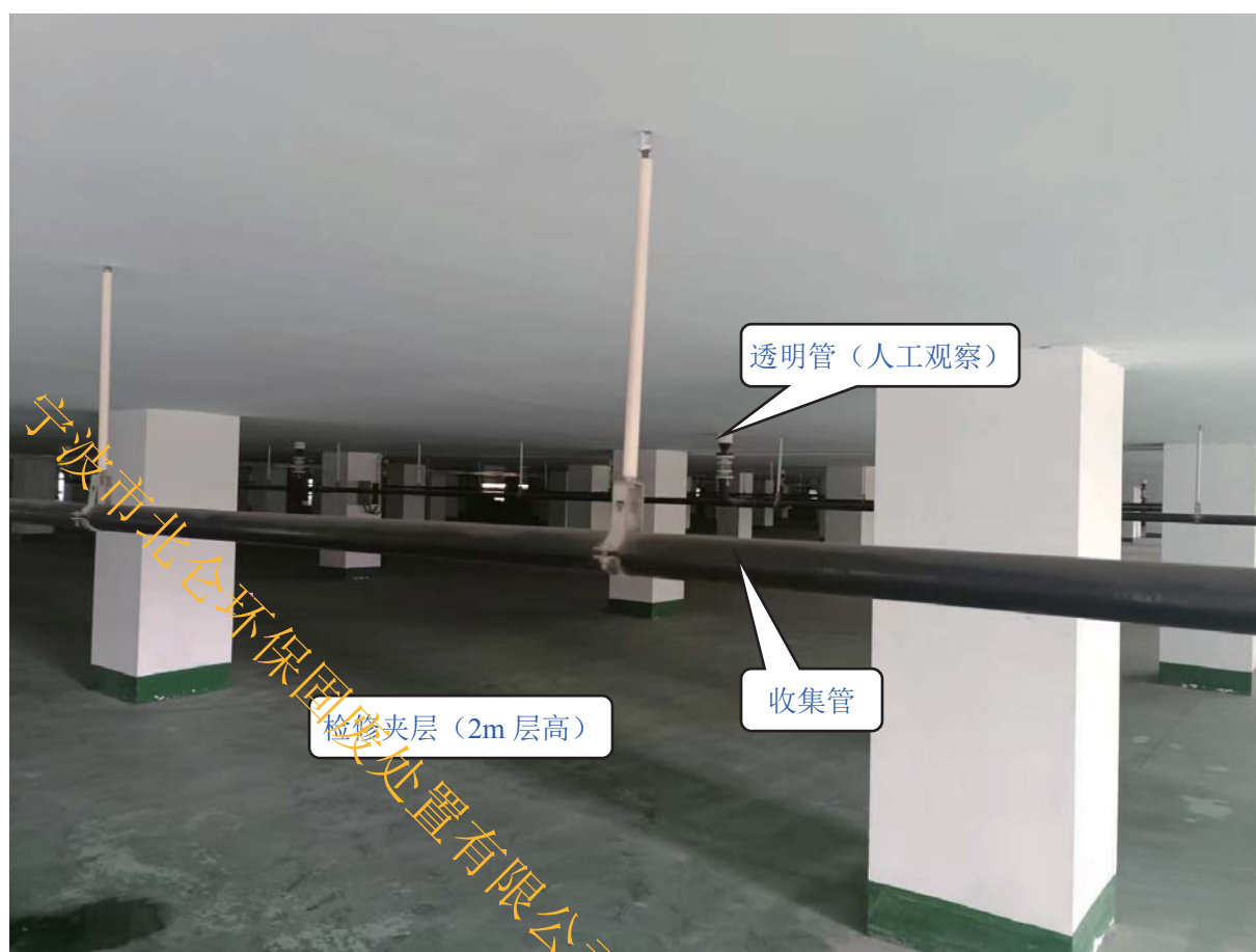
图 4.13-2 刚性填埋场检修夹层内的渗滤液收集管路（样图）
