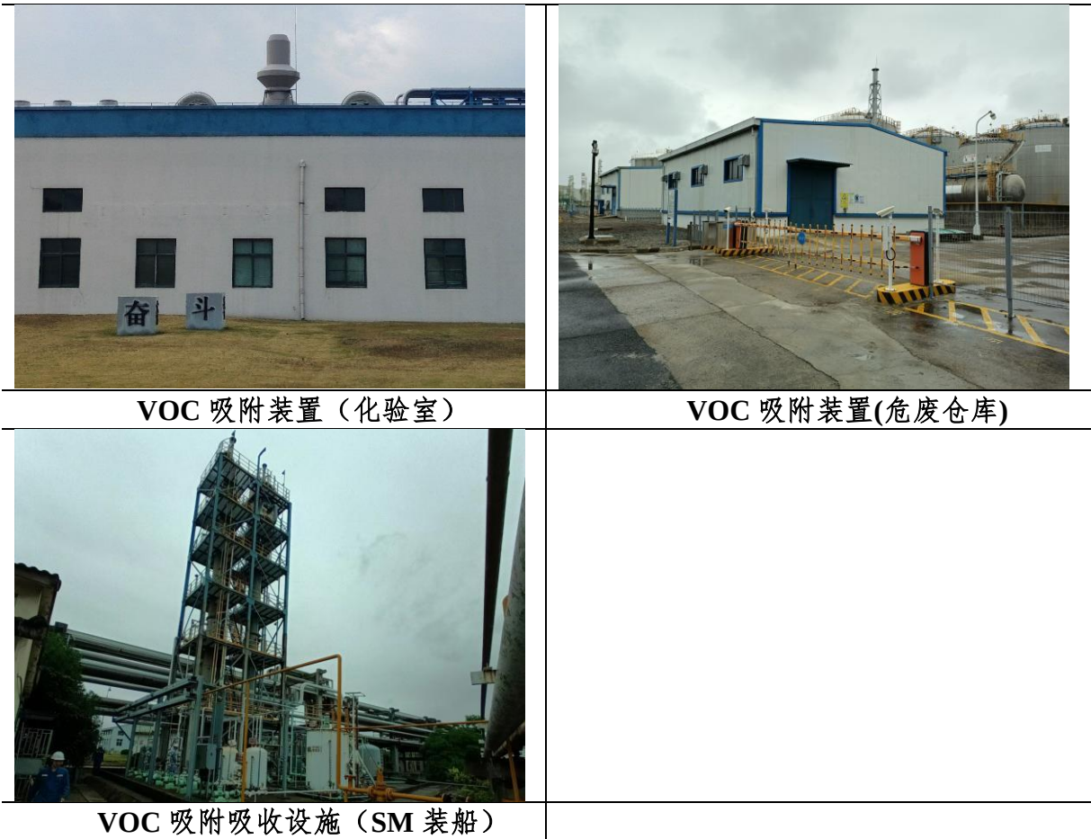
图 3.7-2 现有工程主要废气治理设施及应急处置装置影像资料
