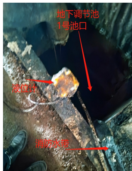
高浓污水抽至调节池的入口
