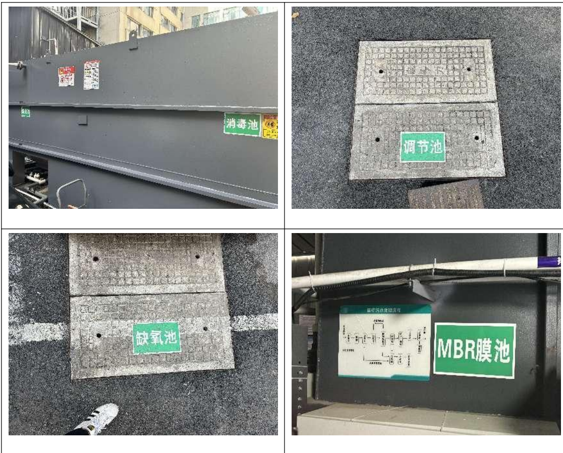
医疗废水处理设施
