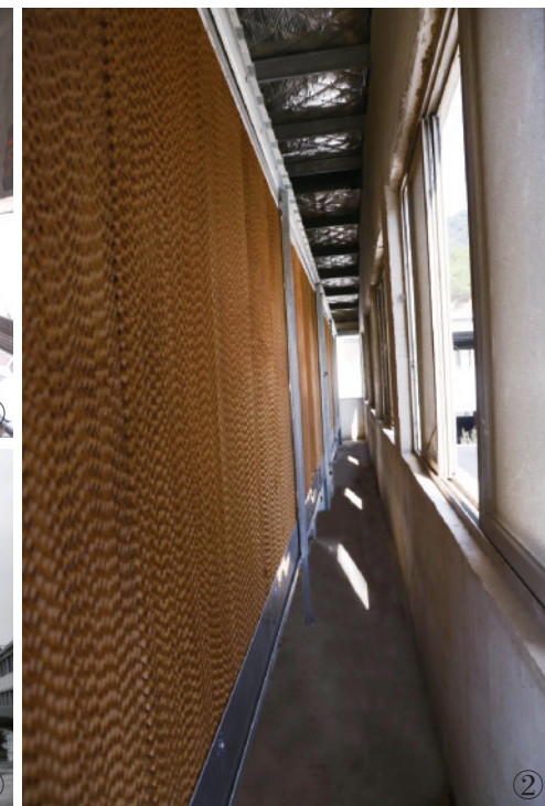
① 建德市鑫欣生猪养殖有限公司自动喂料系统 ② 建德市鑫欣生猪养殖有限公司除臭系统 ③ 建德市鑫欣生猪养殖有限公司除臭系统外机
