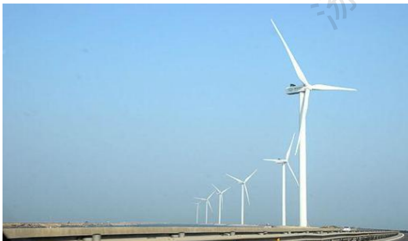
风能供电装置
