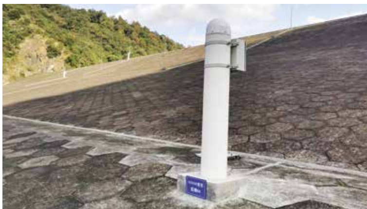
2021年10月12日,柯桥区平水江水库大坝安全监测系统完工 (李红波 摄)
