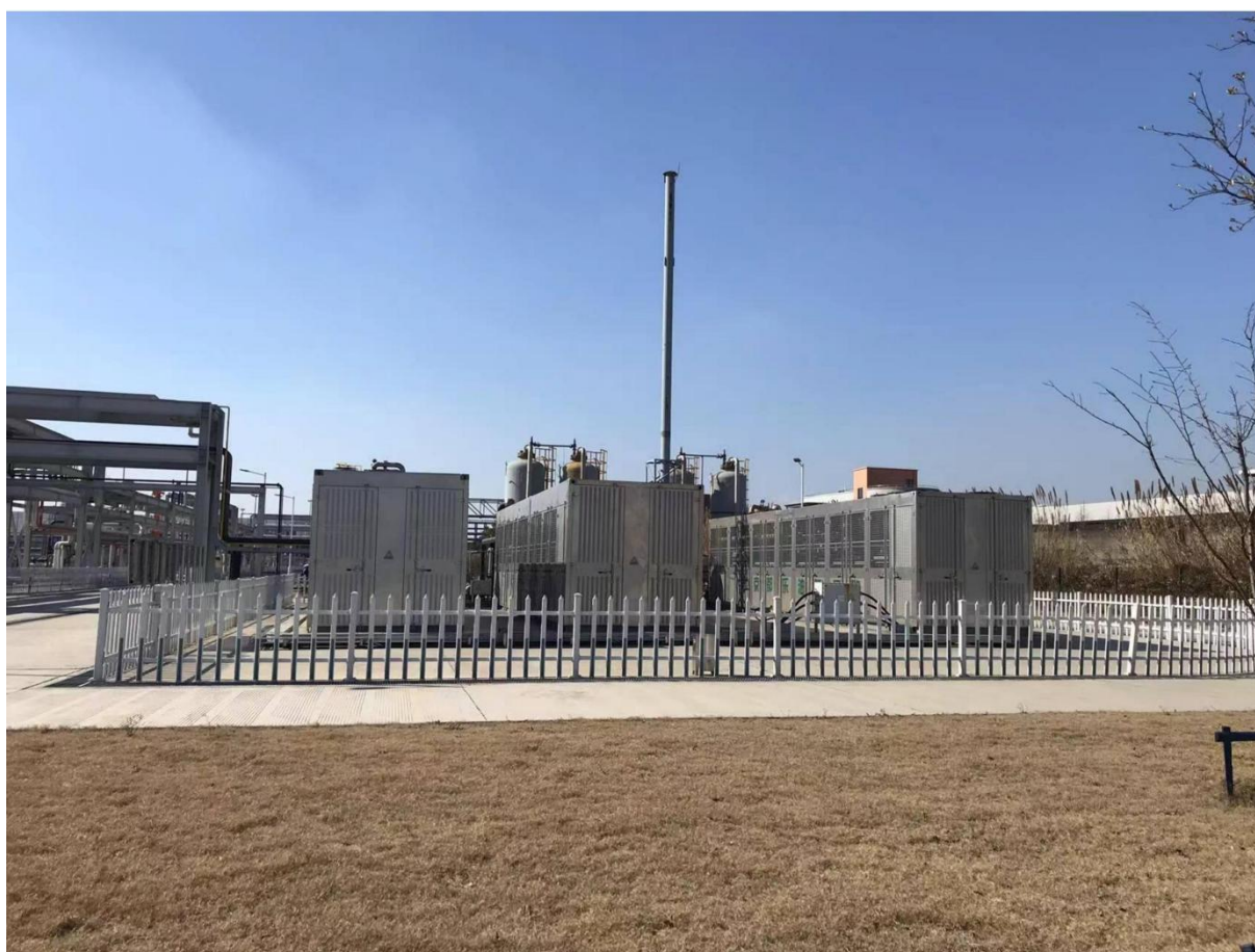
图 3-3 废气处理设施
