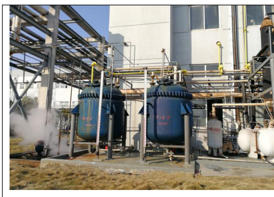
含腈废水破氰预处理
