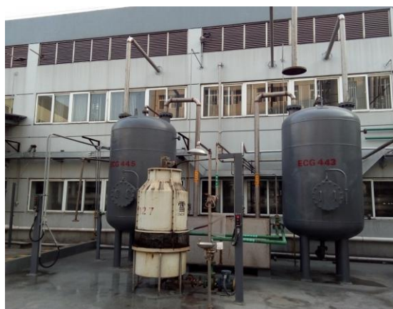
208 车间（含氢废气水封装置）
