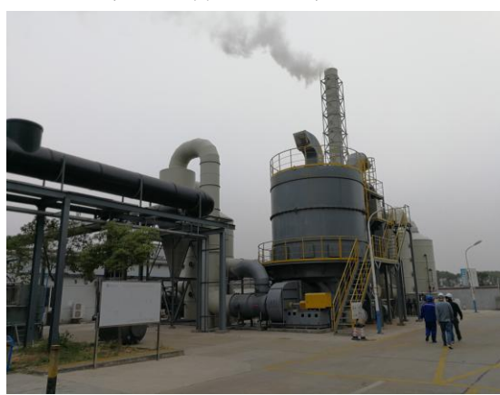
厂区有机废气集中处理（一级碱洗+RTO 焚烧+二级碱洗+5#排气筒）
