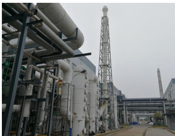
207 车间（水吸收+碱吸收+3#排气筒）
