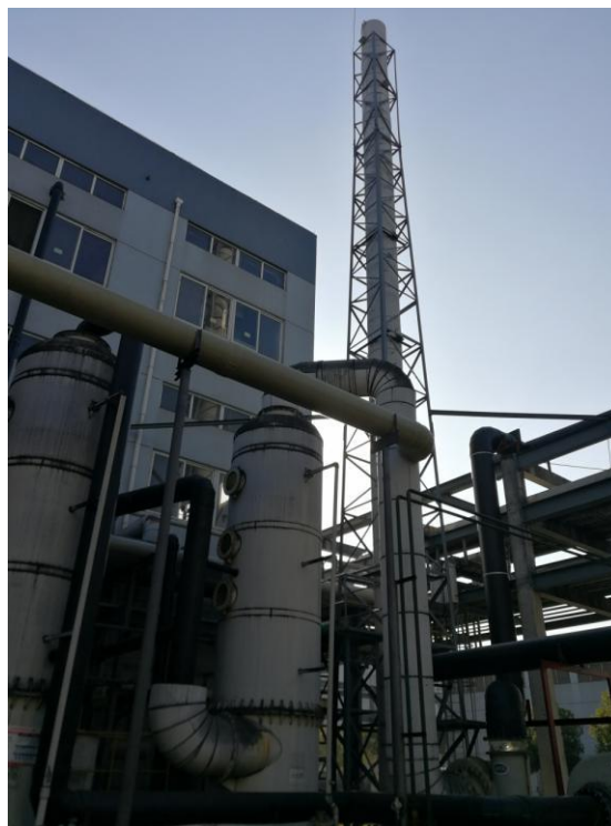
206 车间（二级酸吸收+2#排气筒）
