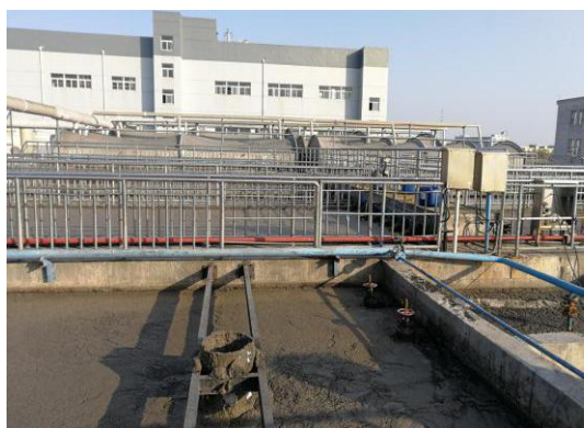
厂区综合污水处理站
