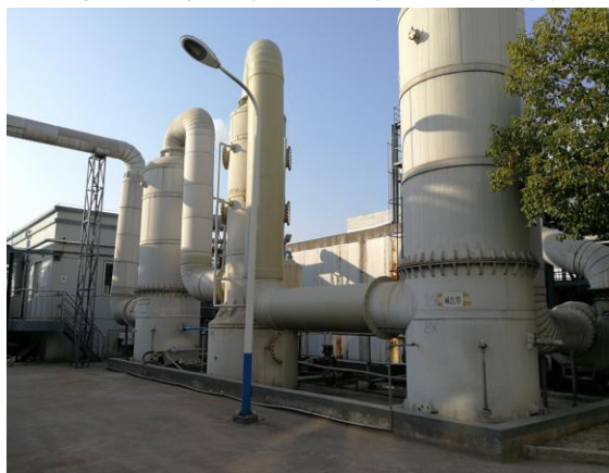
污水站废气、危废仓库废气预处理（一级酸洗+一级水洗+一级碱洗）
