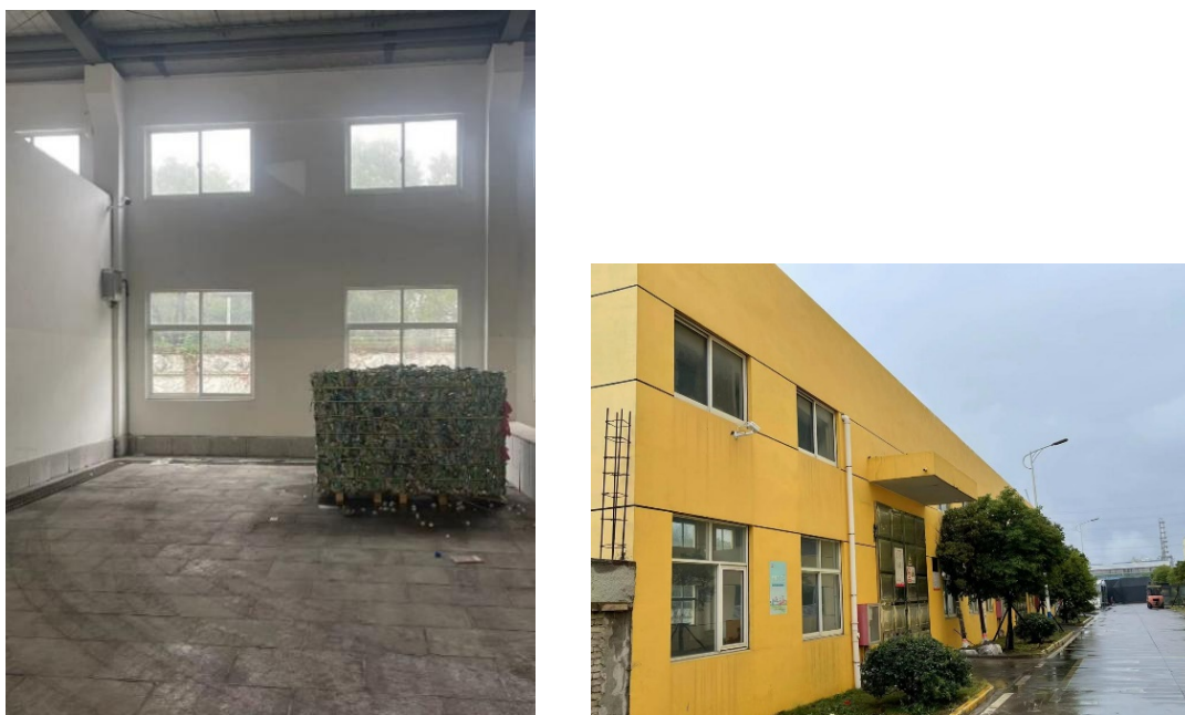
图 3.3-5 危废暂存库照片（摄像头安装照片）
