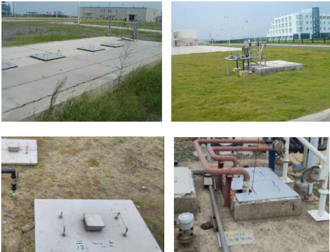
图 3.3-1 现有工程接收站生活污水处理系统
