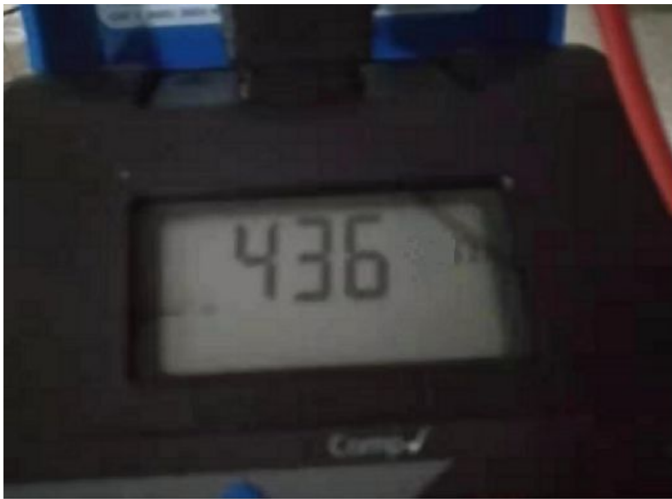
图 3 红色照明火线一段绝缘电阻现场检测情况
