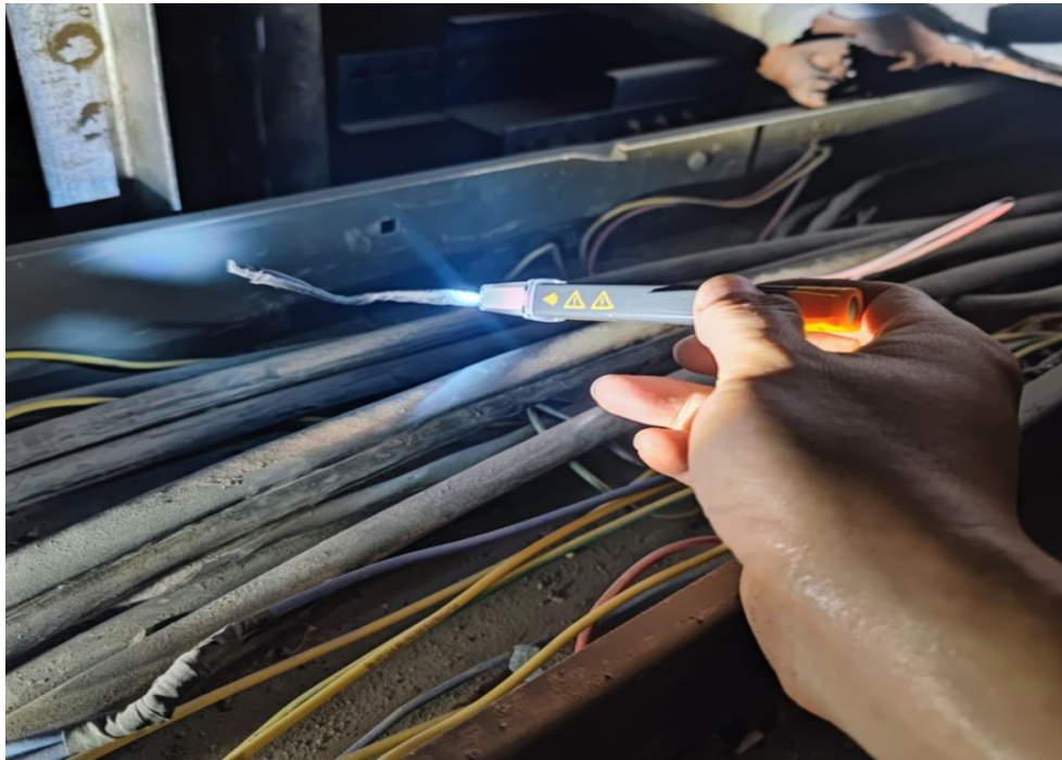
图 2 照明日光灯红色接入电源线绝缘不足现场图
