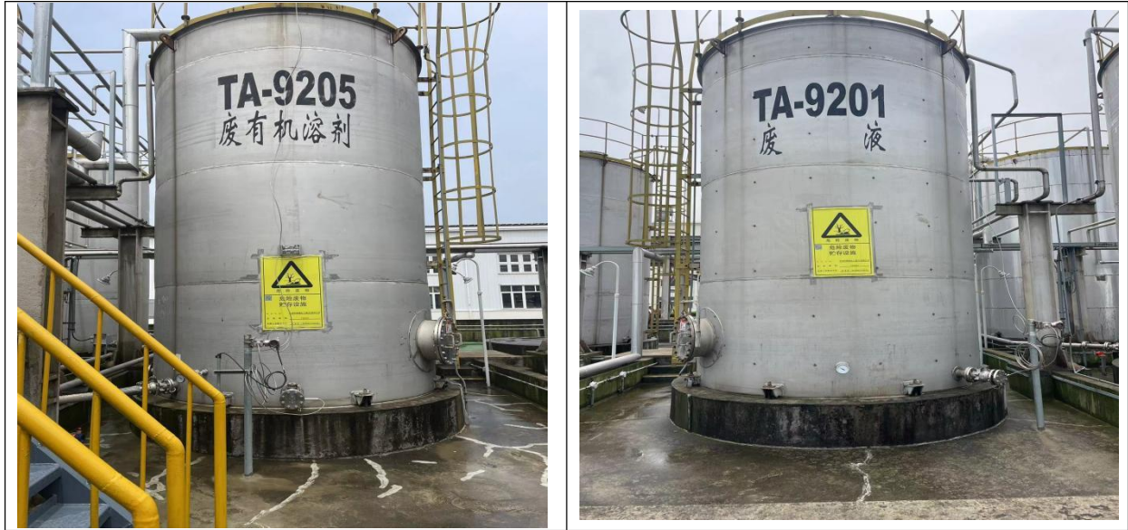
图 3.6.3-1 危废贮存场及废液储罐等相关标识标牌
