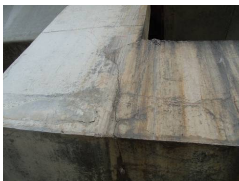
(a) 高低盖梁折角处竖向裂缝
