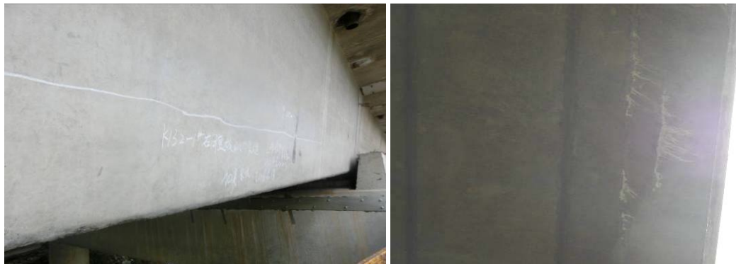
图 2.1.1-1 主梁纵向裂缝病害典型照片
