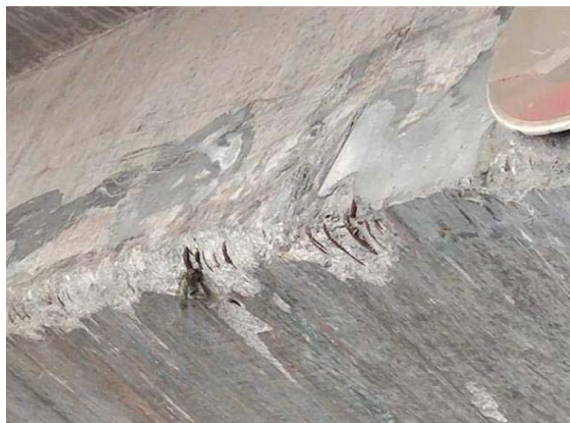
图 2.2.1-2 梁板边角混凝土车辆刷蹭破损、露筋
