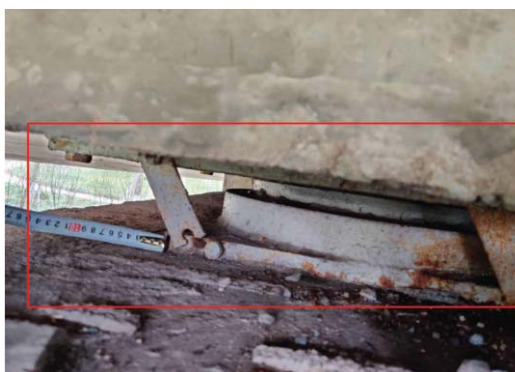
图 4.2.1-4 支座限位未拆除
