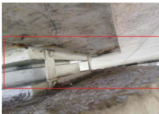
图 4.2.1-2 支座限位未拆除
