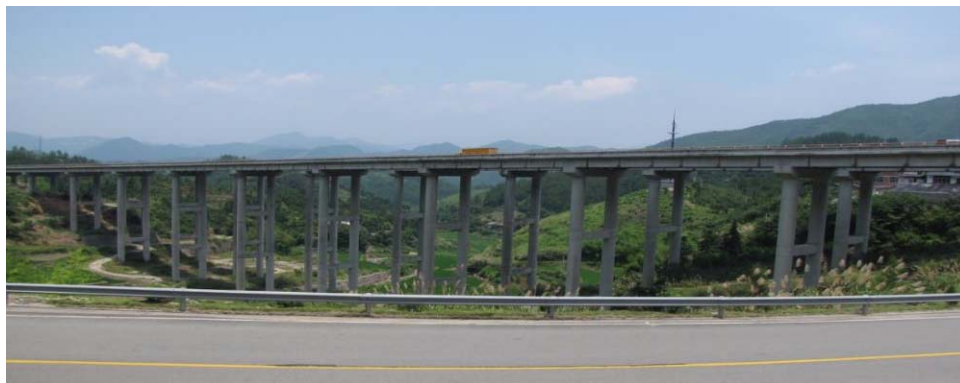
图 6.3.1-1 高桥墩、大纵坡引起的墩柱、梁体偏位
