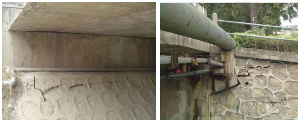
图 6.3.1-2 桥台变位引起的上梁体偏位
