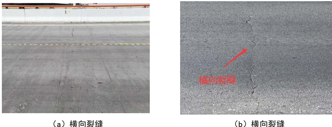
图 5.2.1-1 桥面铺装横向裂缝
