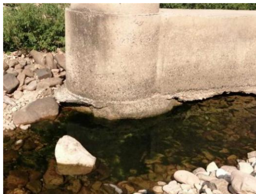
(b) 桩基础冲刷
