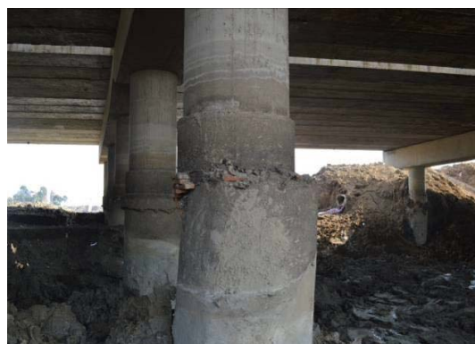
(b) 桩柱接头偏位
