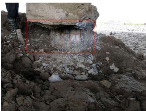
(a) 桩柱接头偏位
