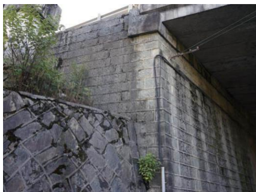
(b) 侧墙开裂
