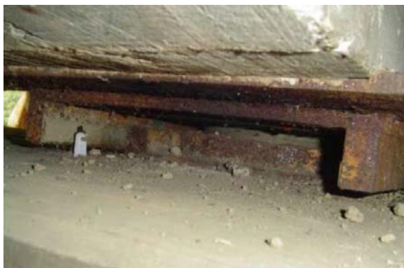
图 6.1.1-3 盆式支座损坏
