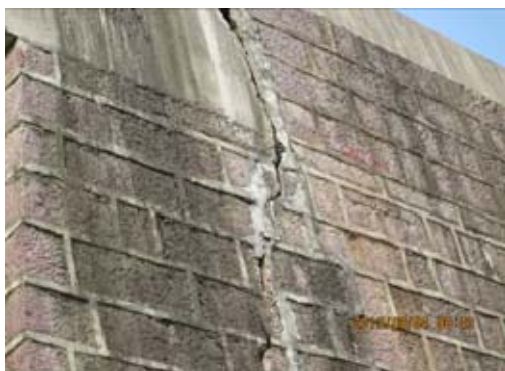
(a) 侧墙开裂
