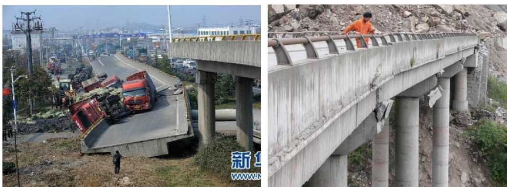
图 6.1.1-9 弯梁桥偏位病害引起的破坏
