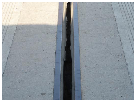
(a) 伸缩缝展开过大
