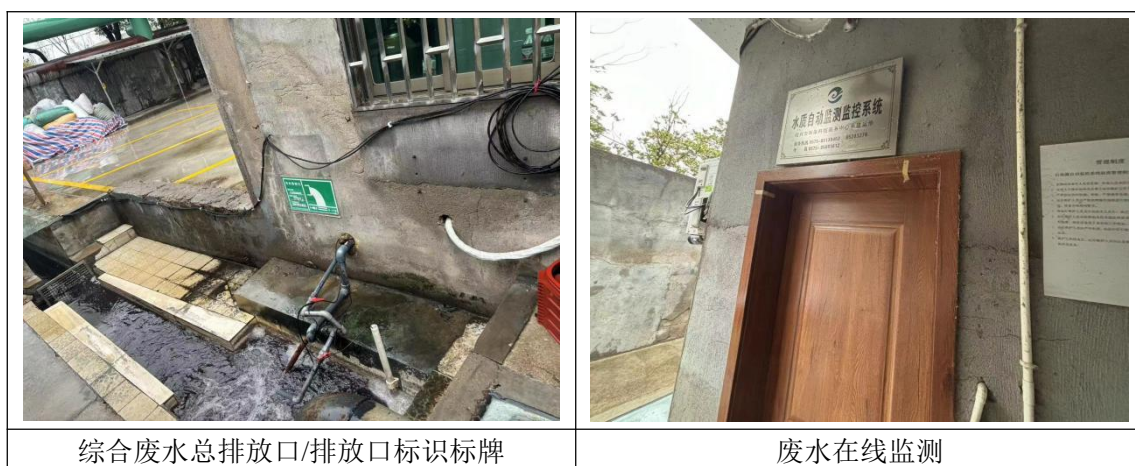
图 3.1-15 生产废水处理设施实景照片（部分）
