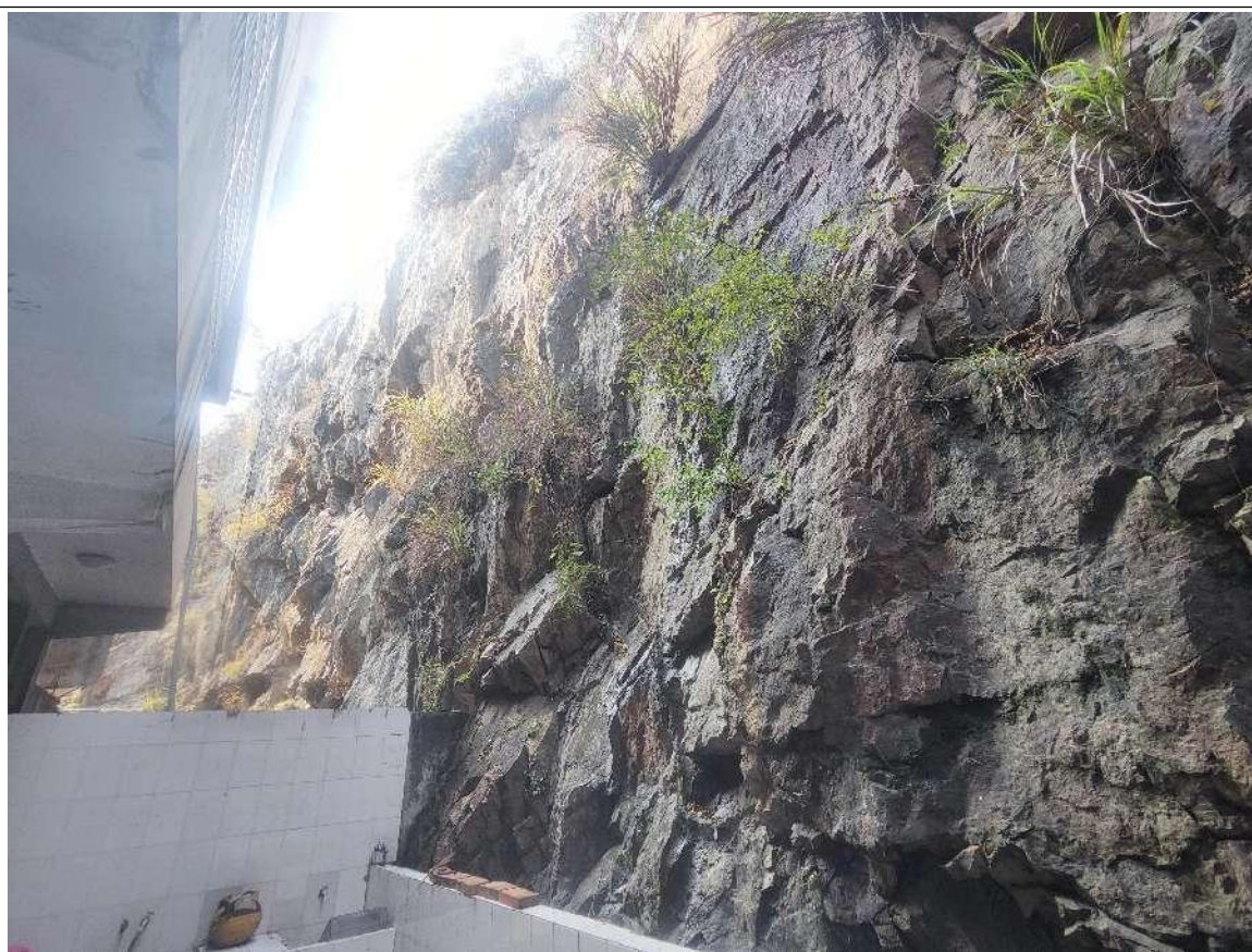
照片 1 边坡坡面节理裂隙发育（镜像西北）
