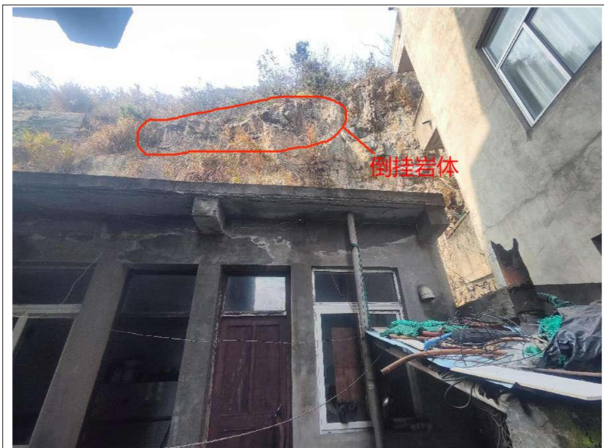
照片 2 边坡坡顶局部发育倒挂危岩体（镜像北）
