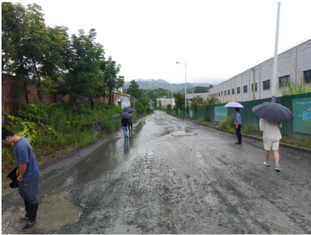
现状雨天路面积水汇流路侧
