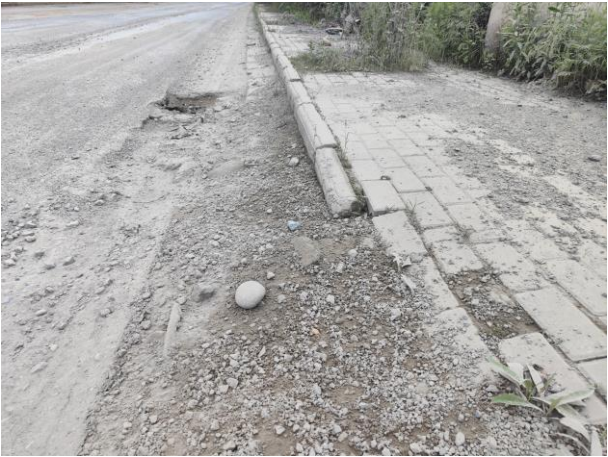
现状人行道及侧石破损
