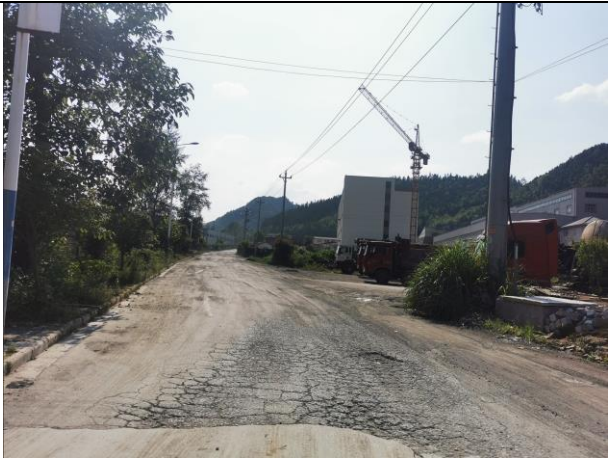
现状路面大面积网状裂缝
