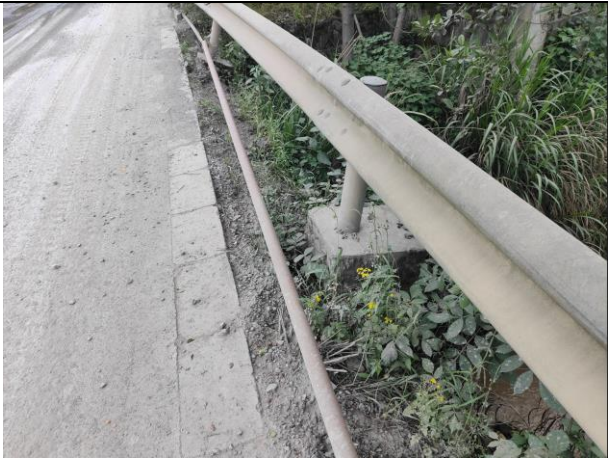
现状桥面钢护栏翻倒
