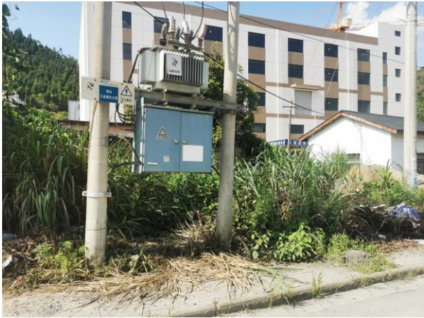
现状人行道外侧园区变压器
