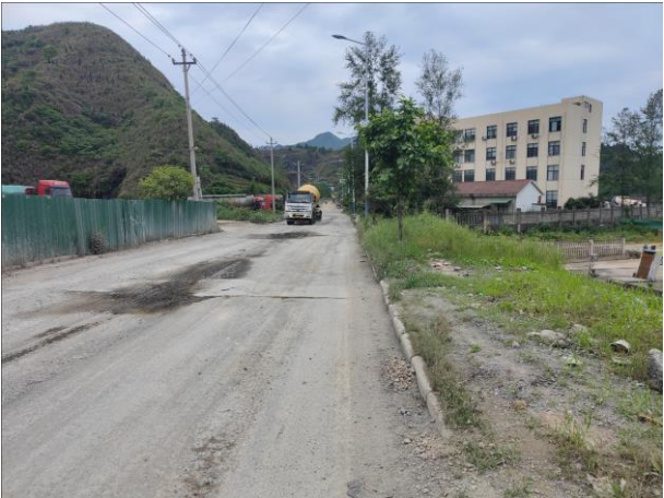
现状重车通行及路面破损
