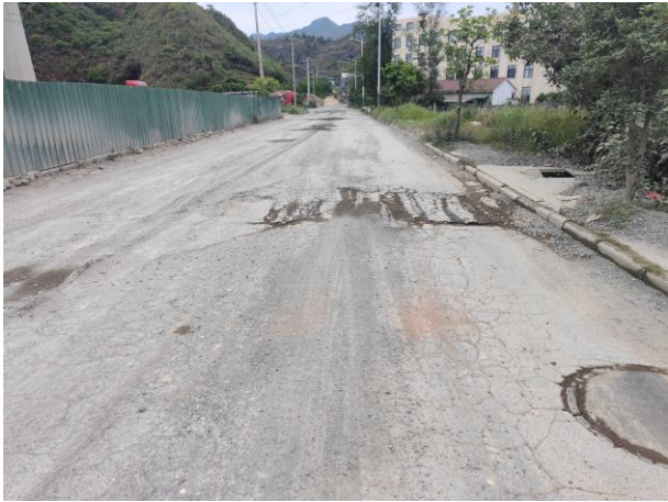
现状路面病害破损情况
