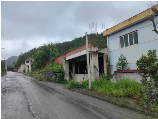
现状双优检测架空层开口及高差
