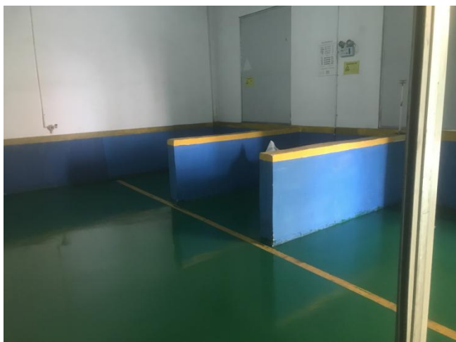
危险废物暂存间分区设置
