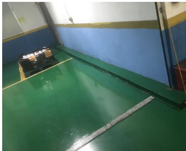
危废暂存间内设置导流沟
