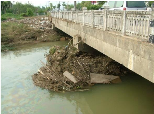
淀北沿山渠桥阻水
