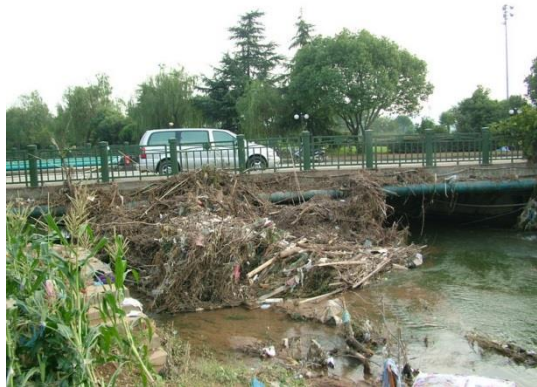
淀北沿山渠桥阻水
