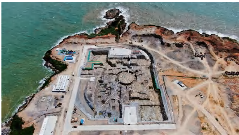
9月9日,浙江三澳核电项目1号机组常规岛主体工程开工
