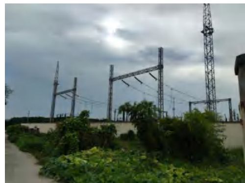
萧山 2#变电所南侧
