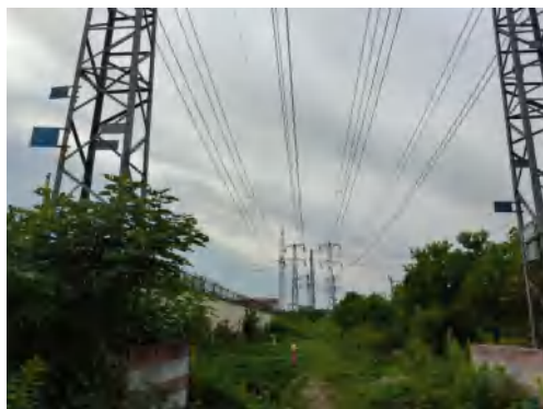
萧山 2#变电所东侧
