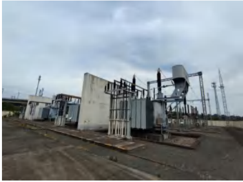
萧山 2#变电所内主变
