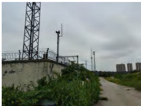
萧山 2#变电所西侧
