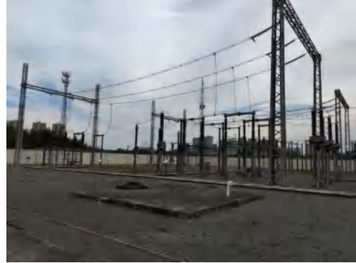
萧山 2#变电所内 220kV 配电装置
