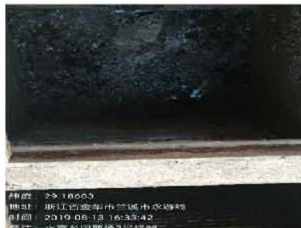
水亭乡周邵汤村管道淤积
