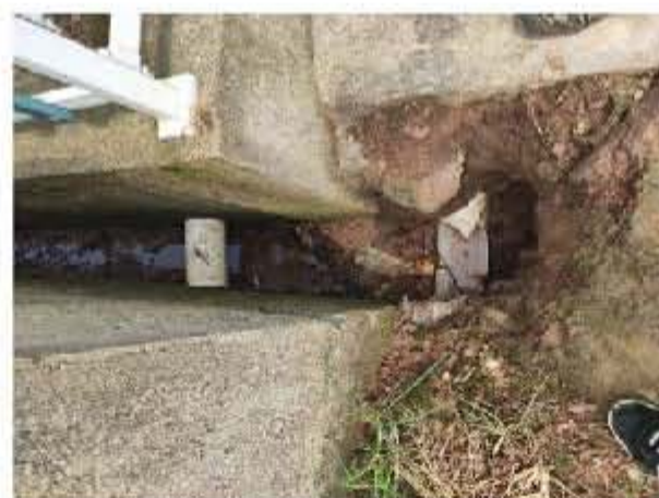
兰江街道何夏庄终端管道破损
