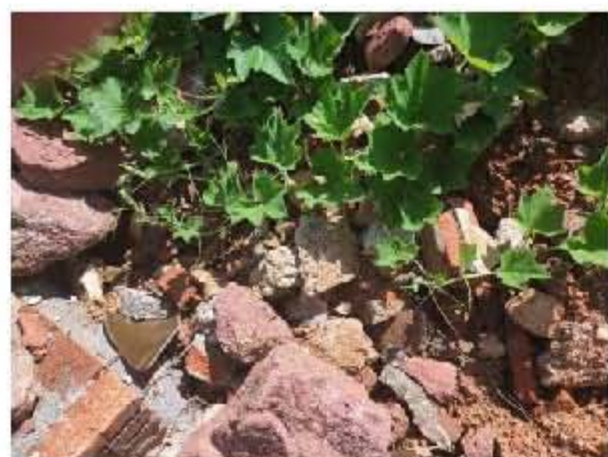
黄店镇三泉村终端出水管堵塞、被掩埋
