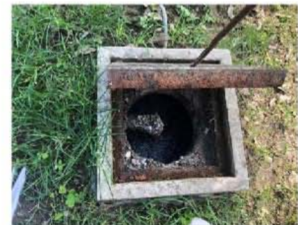
云山街道檀树终端检查井锈蚀、雨污混流
