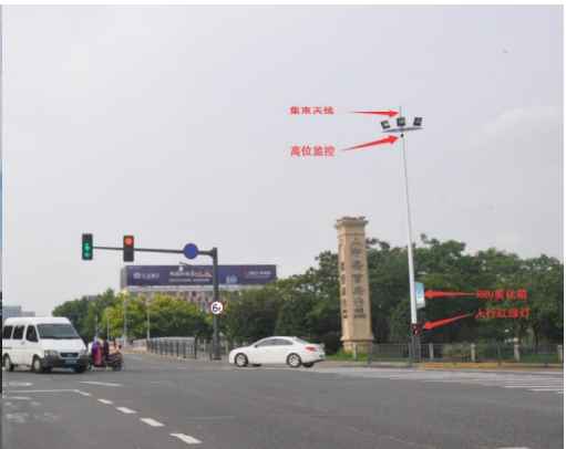
图 8-5 高杆，RRU 上塔
