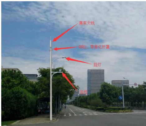
图 8-4 高杆，RRU 上塔（带美化外罩）
