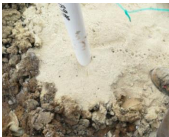
B9 地下水监测井
