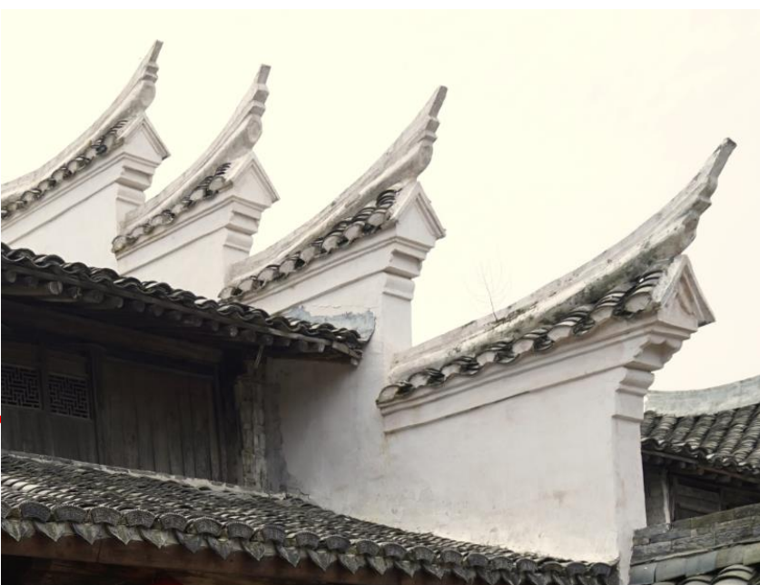
奉化 马头村文保点老酒坊阊门二进东厢马头墙维修后,水泥过度涂抹
