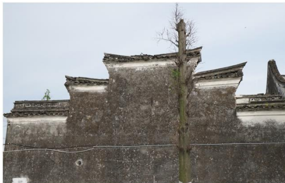
图 3-2 江北庄桥马径乾坤房山墙
