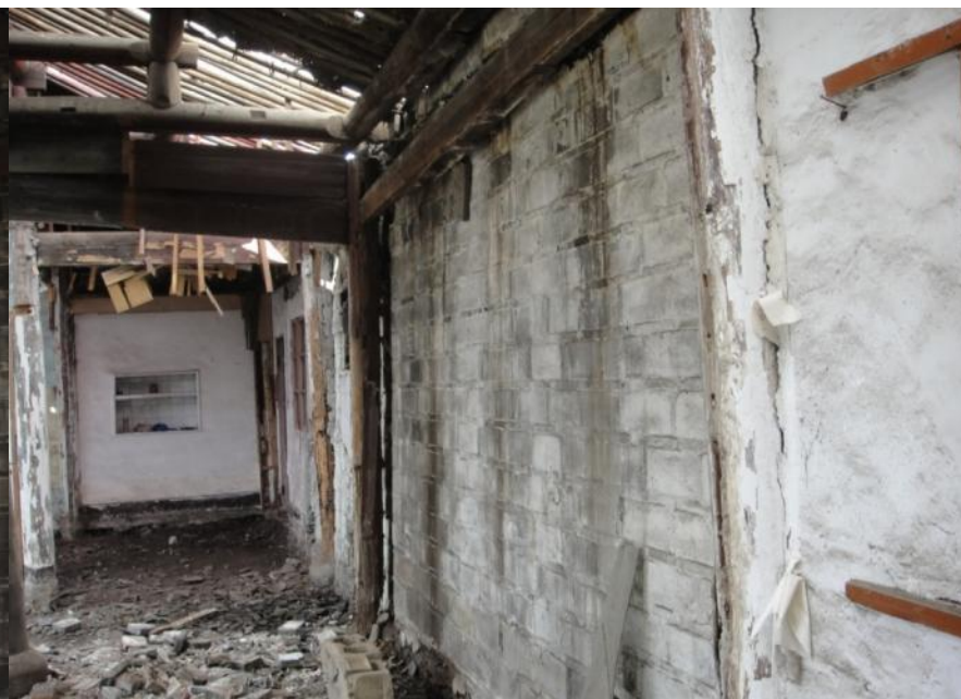
正厅后排柱梁变形腐朽，后檐墙变形严重
