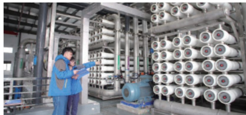
■ 高山净化水厂双膜车间
