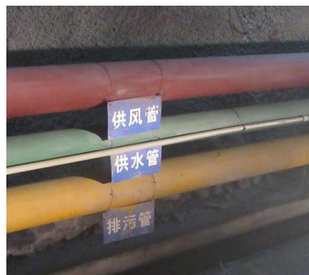
供风、供水实例图
