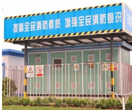
配电柜实例图
