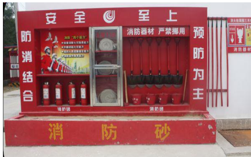
消防设施实例图
