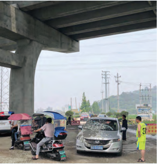
左图：高速公路施工单位安全防护措施不到位，造成平交口过路车辆被坠落的混凝土砸中 右图：人大代表们约见高速公路有关负责人，要求解决安全防护问题
