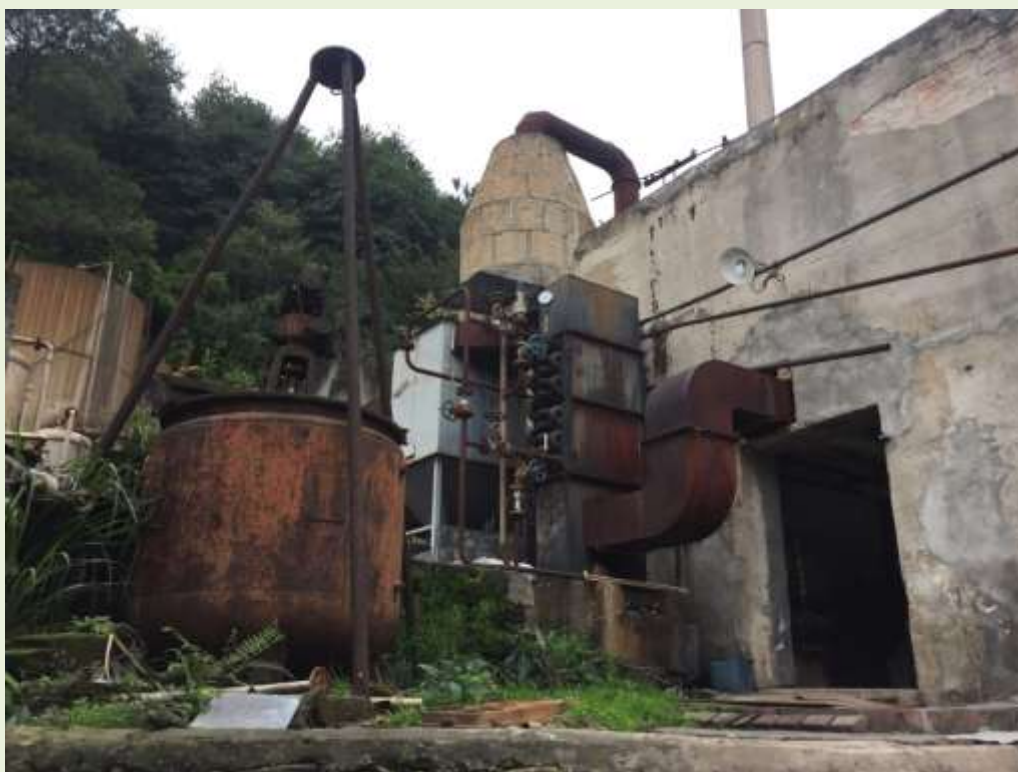
图 3.8-3 燃煤烟气旋风+水膜塔
