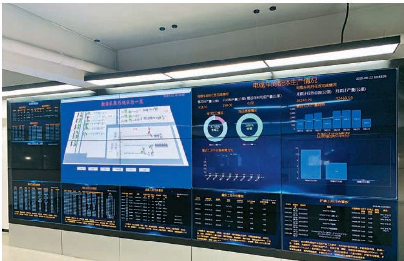
图 141 杭州临安森源电缆有限公司物联网工厂控制室(区经信局提供)
